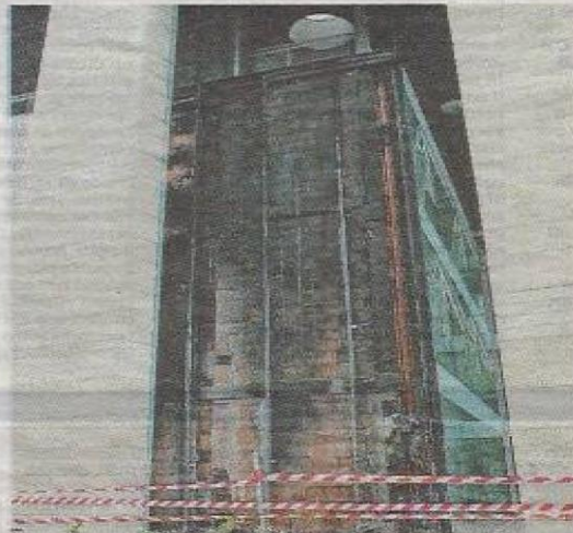
Distrutta La facciata del distretto socio-sanitario
